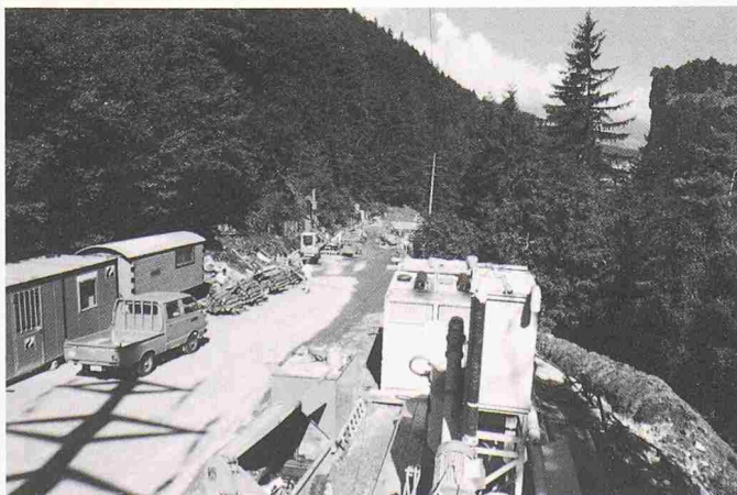
Bild 7. Situation auf der alten Via Mala: Installationen
