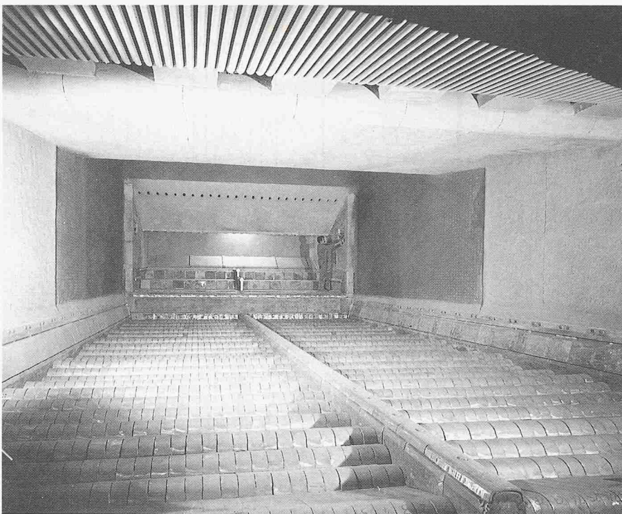
Bild 1. Verbrennungsraum mit zweibahnigem Gegenlauf-Überschubrost und Zuteiler
