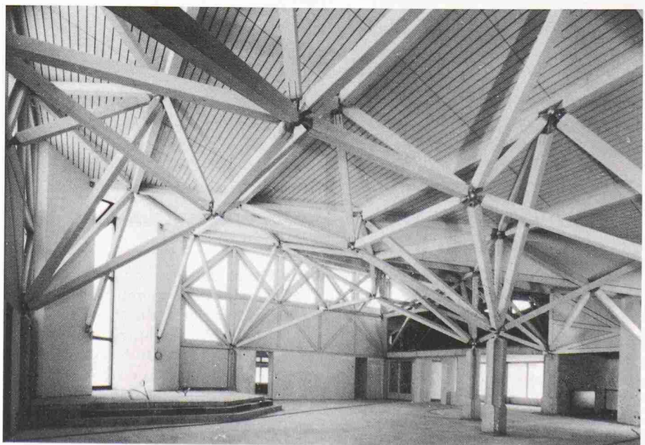
Die Kirche «St. Katharina von Siena» in Fällanden grenzt an ein Naturschutzgebiet. Im Innern steigern sich die Raumhöhen entsprechend der Bedeutung und werden im hohen Kirchenraum von einem sprengwerkartigen Raumfachwerk gleich einem Himmelsgewölbe überspannt
