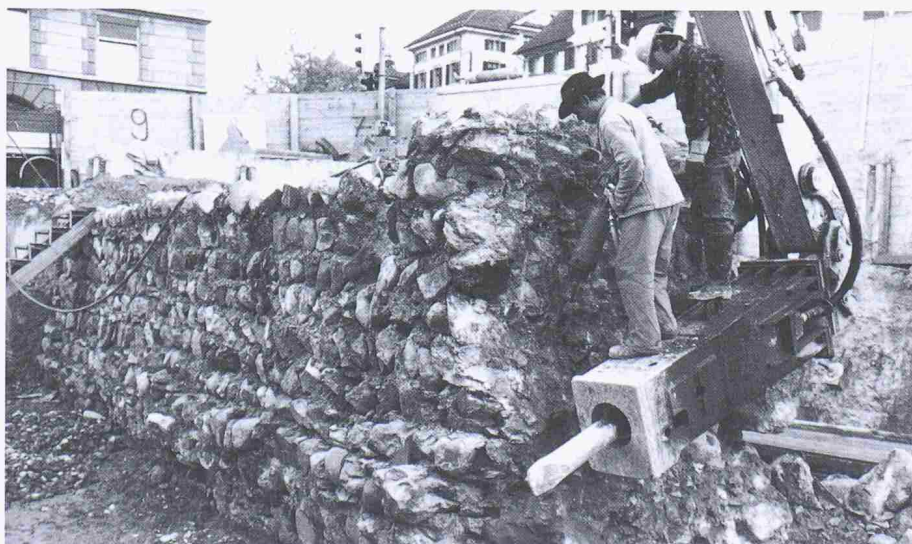
Die Stadtmauerreste in Zürich fallen. Sie mussten dem Neubau der Zentralbibliothek weichen. Erhalten werden zwei kurze Stücke, die evtl. der Öffentlichkeit zugänglich gemacht werden (Bild: Comet)
