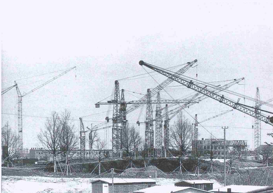
Das Ende des Baubooms scheint sich abzuzeichnen. Vor allem bei Grossprojekten führen die unsicheren Wirtschaftsaussichten immer häufiger zum Bauverzicht (Bild: Comet)
