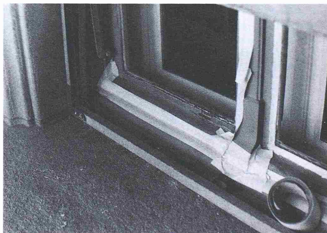
Bild 1. Jede Nassreinigung an einem Gebäude erfordert eine sorgfältige Abdichtung allfällig offener Fugen
