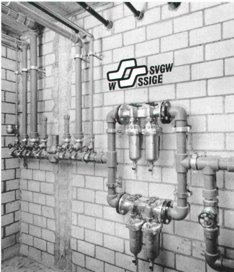
Verteilerbatterie in der Mövenpick-Raststätte «Heidiland» bei Sargans
