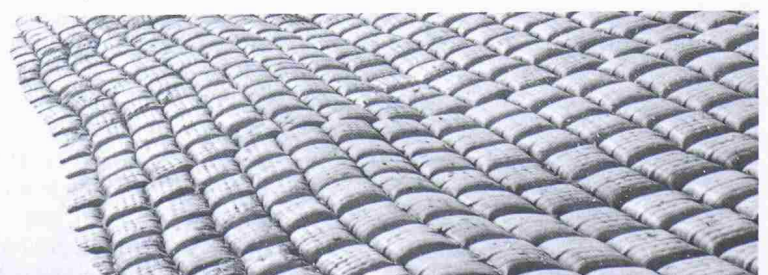
Bild 3a. Mit Pumpbeton verfüllte Gewebeschalung für Plattenmatten zur Sohl- und Böschungbefestigung für Rückhalte- und Absetzbecken sowie Flüsse und Kanäle (Mohr)
