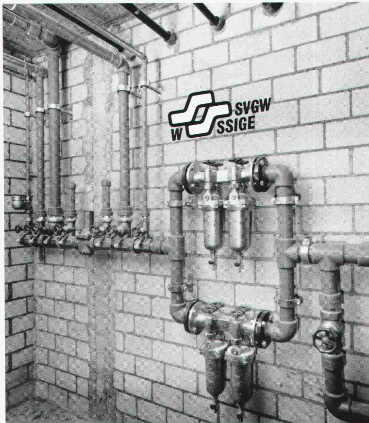
Verteilerbatterie in der Mövenpick-Raststätte «Heidiland» bei Sargans
