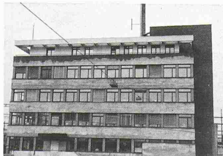
Bild 1. Gebäude-Ansicht. Die Stahlbetonstützen zwischen den Fensteröffnungen müssen auch den Stockwerk-Schub aus Windlasten aufnehmen. Diese Stützen bilden zusammen mit den Geschossdecken eine relativ biege-weiche Rahmenkonstruktion
