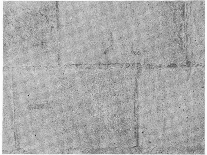
Bild 11. Dieser «Zementanwurf» gleicht eher einer Glasur. Die dünne, feinkörnige, mit zuviel Wasser angemachte Mörtelschicht «verdurstete» auf dem stark saugenden Backstein und konnte nicht voll erhärten
