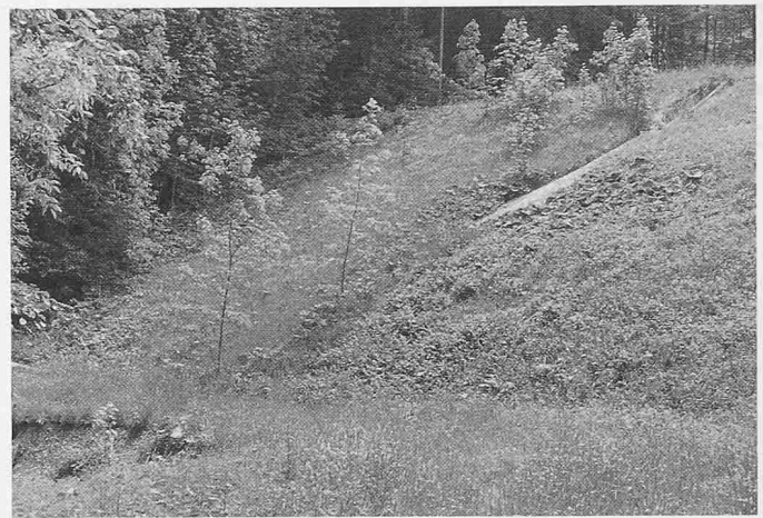
Bild 12. Luftseitige Ansicht des Dammes am Sülbach ZH mit den 1984 erlittenen Auswaschungen (Foto des Autors)
