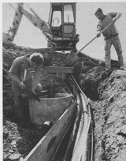
Unterhalb des Tunnels der Jungfraubahn ist die Abwasserleitung neben elektrischen Leitungen und verschiedenen Werkleitungen im Boden verlegt. Kontrollschacht der Abwasserleitung mit Überdruckstutzen
