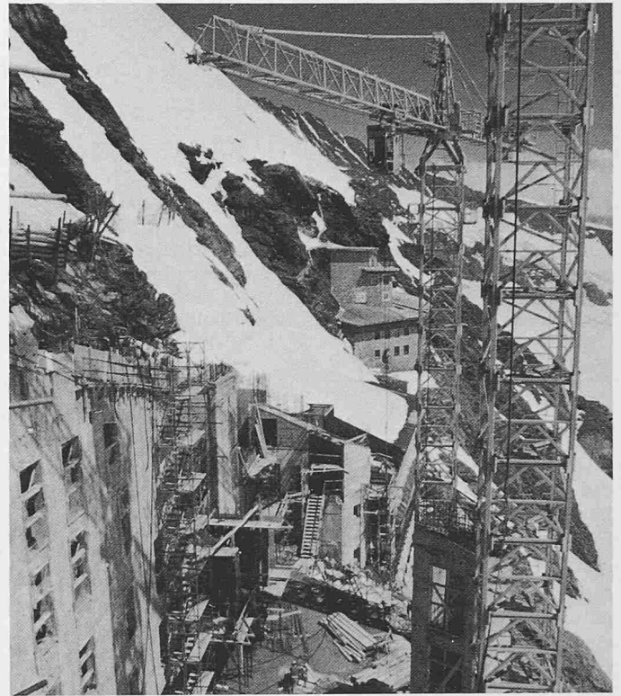
Zwei speziell für das Jungfrauoch konstruierte Baukrane wurden – wie alle andern Bauteile in kleine Elemente zerlegt – mit der Wengernalpbahn und der Jungfraubahn auf 3450 m Höhe transportiert. Für den Kranführer eine verantwortungsvolle Aufgabe hoch über dem Aletschgletscher; die Höhe des Aufstiegs über die vereiste Stahlleiter zur Krankabine unterstrich diese Verantwortung
