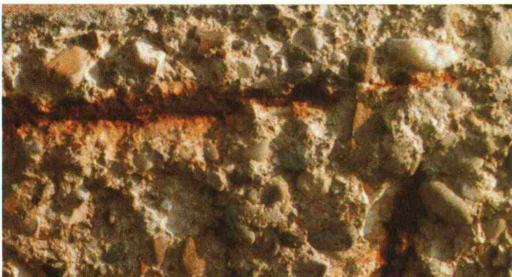
Betonabplatzungen infolge starker Armierungskorrosion.
