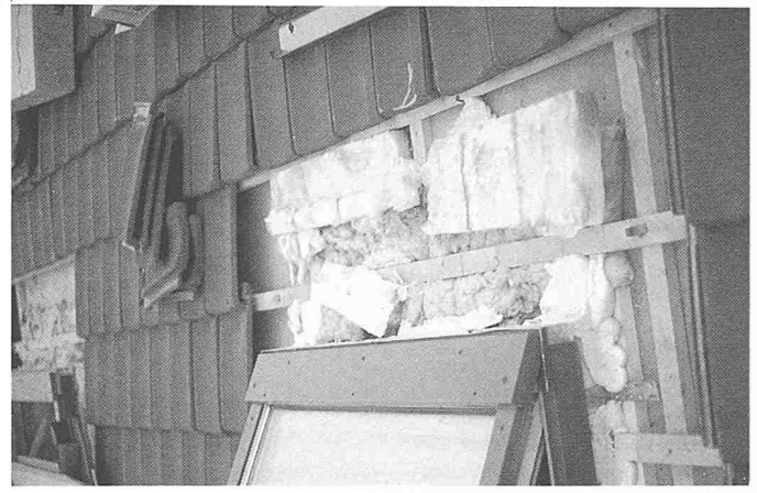
Bild 2. Falsch: Isolationsmaterial stark gestopft - reduziert dessen Wirksamkeit. Infolge fehlender Unterlüftung bleibt das Kondenswasser in der Wärmedämmung und tropft schliesslich ins Hausinnere zurück
