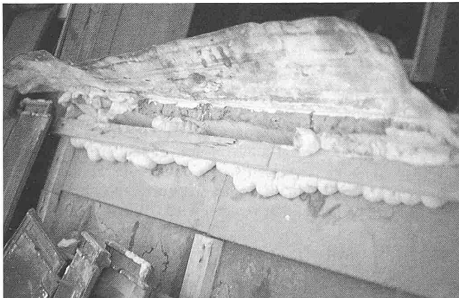
Bild 3. Falsch: PU-Schaum ist keine ausreichende Luftdichtung, aber auch seitlich ist kein Abführen des Kondenswassers möglich
