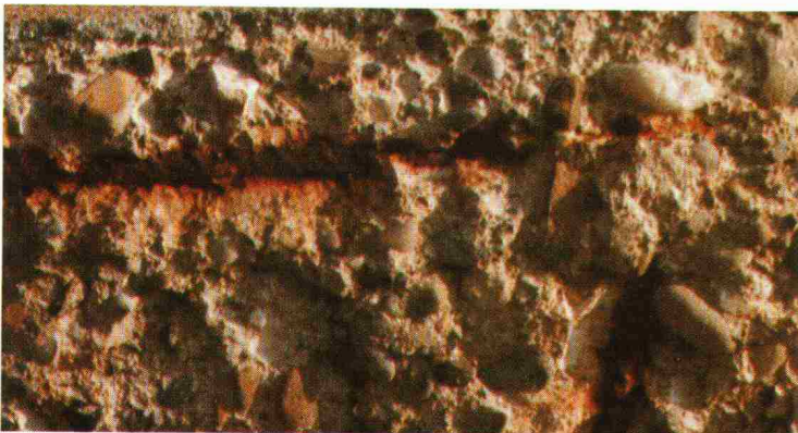
Betonabplatzungen infolge starker Armierungskorrosion.
