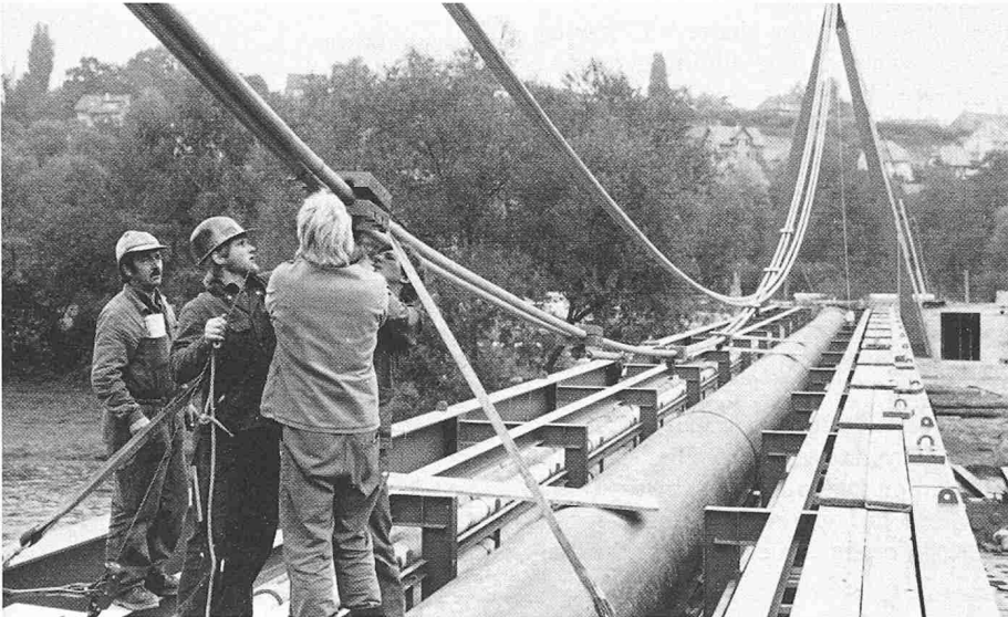
Bild 4. Befestigung der Hängeseile an den Tragkabeln mittels Klemmen
