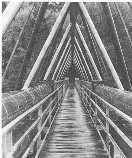
Bild 3. Durchblick mit Rohrleitungen
