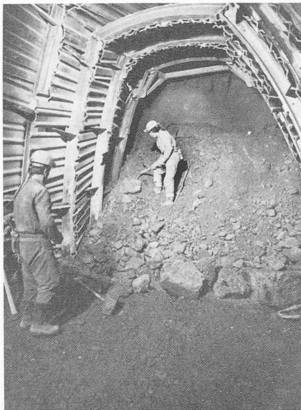
Bild 5. Oberer Paramentstollen Marciavanti-Vortrieb mit Hilfsbogen. Ortsbrust im oberen Bereich mit Spritzbeton gesichert.
