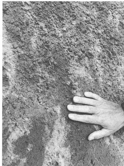
Bild 13. Unregelmässige Spritzbetonoberfläche (schwankende Rauheit)
