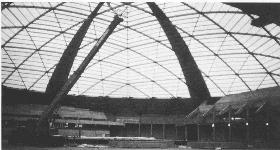
Bild 29. Halle in Tacoma (USA) mit rund 160 m Durchmesser. Bauzustand: Netzschale mit Beginn der Dacheindeckung
