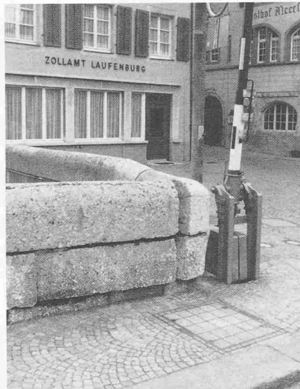
Bild 6. Verschobene Steine der Betonbrüstung am linken Widerlager, vor der Sanierung
