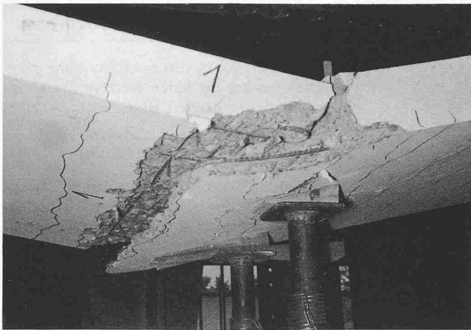
Bild 6a. Bruchzustand (Plattenstreifen 1)
