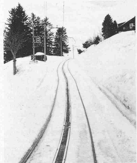
Bild 6. Verschiebung des Bahngelises als Folge der Hangrutschung vor der Sanierung
