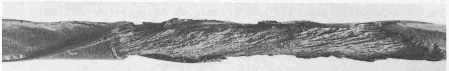
Bild 6. Korrosion an einem oberen Bewehrungsstab der Fahrbelagplatte einer achtjährigen Brücke infolge Eindringens von Salzlösungen durch undichte Brückenisolation
