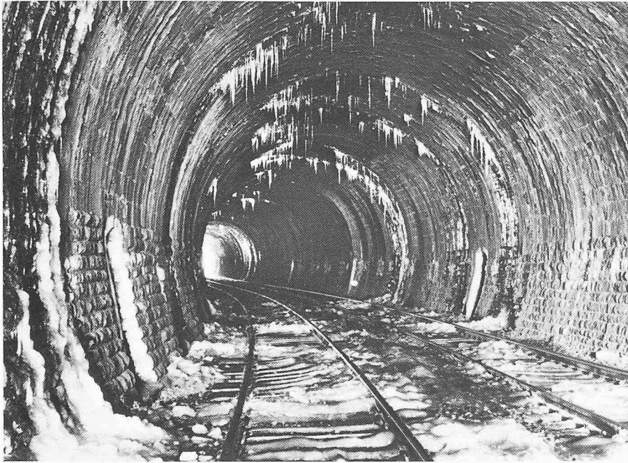
Bild 1. Älterer Eisenbahntunnel vor der Instandsetzung
