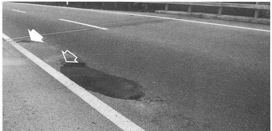
Bild B2. Blick gegen unteren Fahrbahnübergang mit repariertem Schlagloch, Probe 1 wurde im Bereich vor der länglichen Belagsreparatur entnommen
