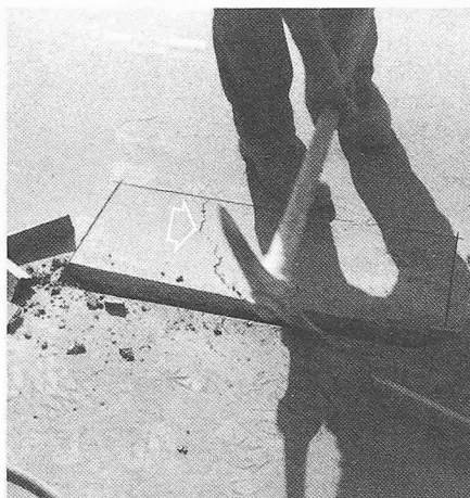
Bild A4. Belagsentnahme bei Querriss; Sichtbarer Riss in der Verschleisschicht
