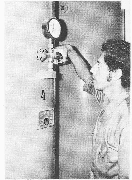
Bild 31. Gefährlich angeordneter Prüfmanometeranschluss
