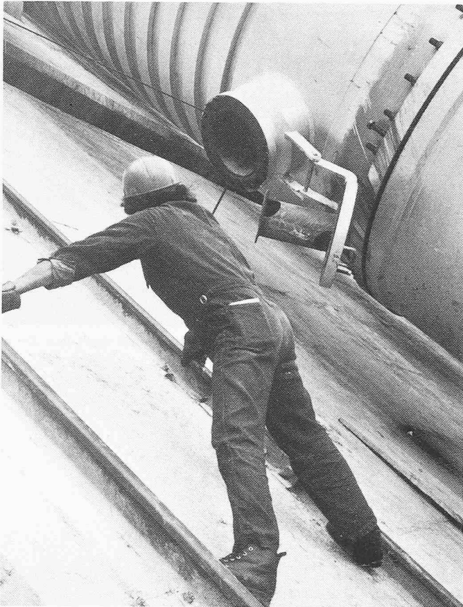
Bild 9. Auf diesem stark geneigten Druckleitungsstrasse fehlt ein horizontaler Zugang zum Mannloch und zur Expansion der Druckleitung, was durch ein Minimum an Koordination in der Projektierung und Bauausführung hätte erreicht werden können
