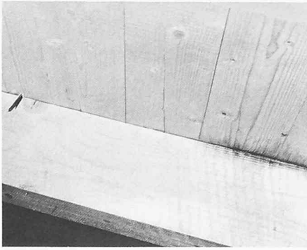
Bild 4. Probeöffnung im Gebäudeinnern. Deckenverkleidung und Wärmedämmung entfernt, Sparren und Holzschalung des Unterdaches sichtbar. Konterlattnagel nicht im, sondern neben dem Sparren, deutliche Wasserspuren an Sparren und Holzschalung unterhalb des freiliegenden Nagels
