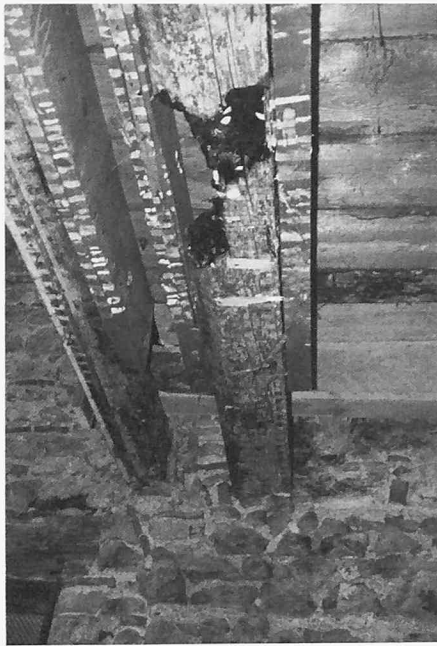
Zerstörter «tragender» Deckenbalken im Haus Pfeffergässlein 8
