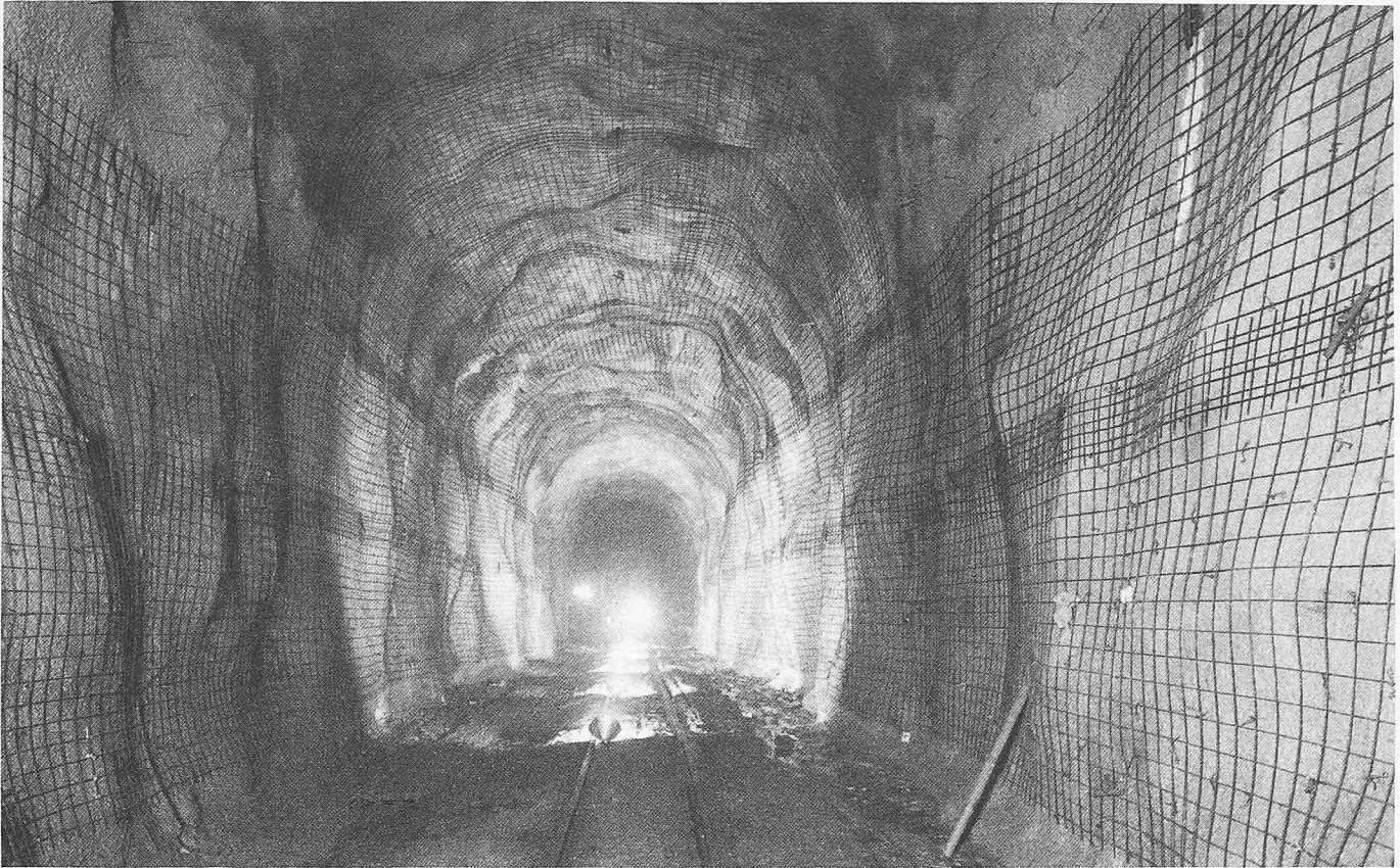
Bild 8. Stahldrahtnetze als Armierung der Spritzbetonauskleidung
