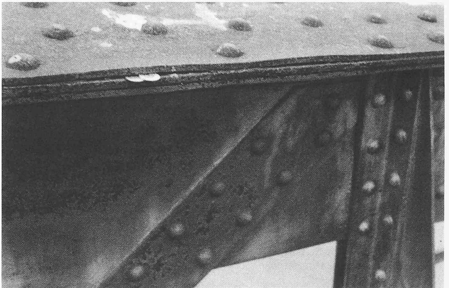
Bild 8. B-001 Stahlfachwerkbrücke über den Rhein, Kaiserstuhl. Rostschäden mit Unterrostung der Lamellen infolge zu grosser Nietabstände
