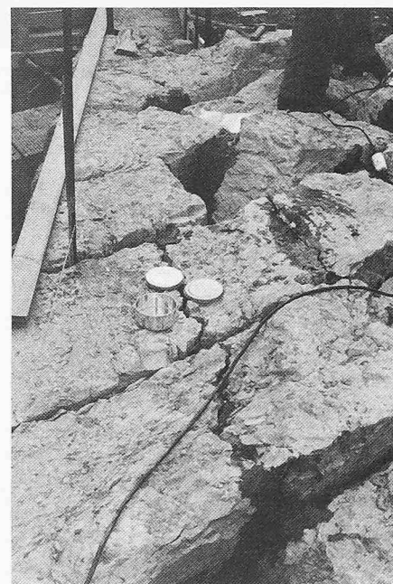
Bild 26. B-414. Risse und Fugen in den abgedeckten Kalksteinen des Gewölbes
