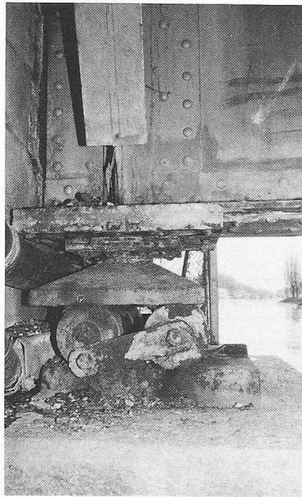
Bild 12. Diese Lager müssen dringend gerichtet und in Ordnung gebracht werden (Reussbrücke B-055, Mellingen)
