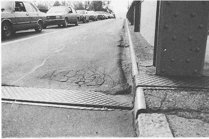
Bild 4. B-003 Rheinbrücke Koblenz-Waldshut. Rosettenförmige Risse im Belag deuteten vor der Sanierung auf Schäden an der Betonoberfläche
