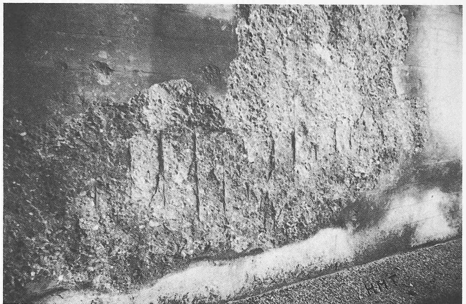
Bild 7. So sahen die Wände einer Unterführung unter der N3 in Rheinfelden nach dem Brand eines dort abgestellten Heuwagens aus
