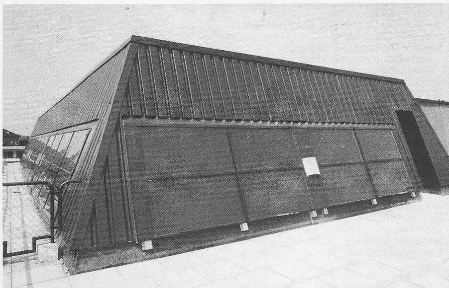
Bild 5. Sonnenkollektoranlage. 32 \text{ m}^2 Kollektorfläche
