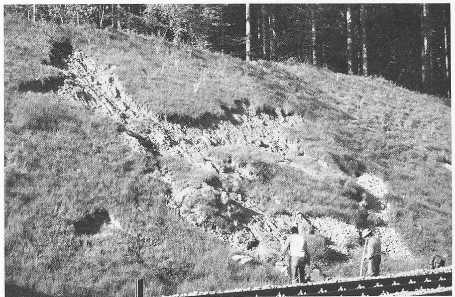
Durch die Einwirkung von Eis und Schmelzwasser wurde die Vegetationsschicht im Frühjahr 1981 wie ein Fell abgeschält. Sie übermurtete die Sickerpackungen am Böschungsfuss
