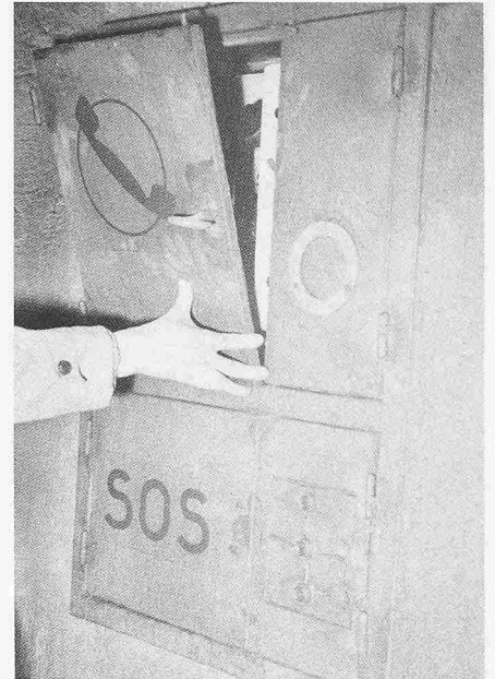
Bild 1. Stark korrodierter SOS-Kasten in einem Nationalstrassentunnel
