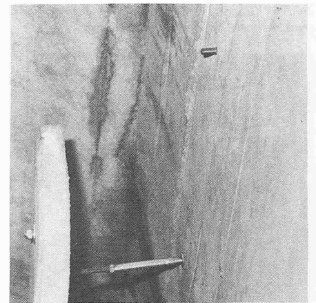
Bild 3. Verkleidungsplatten. Die Tunnelverkleidung aus vorfabrizierten Betonelementen wurde unten abgestellt und oben dann mit zwei speziellen Halteplatten und Klebeankern aus rostfreiem Stahl fixiert
