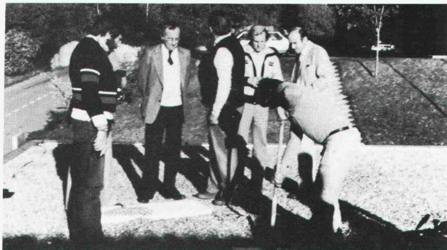
Dachöffnung nach 10 Jahren, gefällsloses Flachdach Waffenplatz Isone, Architekten: Suter & Suter, Generalplaner, Bern.
