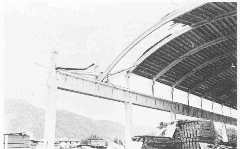
Schäden an einer Lagerhalle in Magnano als Folge des Friaul-Erdbebens vom 6. Mai 1976. Das äusserste Dachsegment ist vollständig heruntergestürzt. Der zweite Dreigelenkbogen fiel nur bis auf den Längsträger hinunter. Der Schaden ist primär durch die knappen Auflager der Dachelemente bedingt
