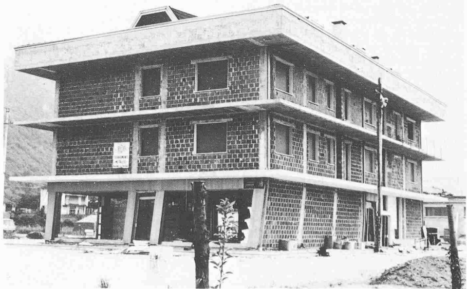
Schäden an einem Wohn- und Geschäftshaus bei Artegna als Folge des Friaul-Erdbebens vom 6. Mai 1976. Die zwei oberen Stockwerke haben sich gegenüber dem untern um das Treppenhaus verdreht (maximale Verschiebung 35 cm). Während die oberen Stockwerke unbeschädigt blieben, ist das Erdgeschoss stark beschädigt. Der Schaden ist durch die geringere Steifigkeit im Erdgeschoss gegenüber der in den beiden höheren Stockwerken bedingt
