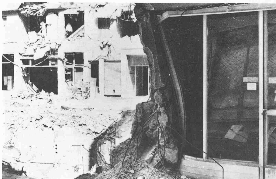
Schäden, verursacht durch den Einsturz des benachbarten Gebäudes, aber auch durch die direkte Einwirkung des Erdbebens (Knicken einer Tragwand)
