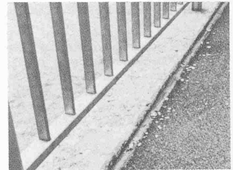
Bild 1. Blättrige Ablösungen haben sich stellenweise zu grösseren flächenhaften Abschälungen ausgeweitet. Vorfabriziertes Randbordelement aus BH 300 mit Dichtungsmittel. 1 Jahr nach Inbetriebnahme, 3 Jahre nach Erstellung
