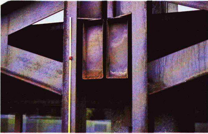
Bild 1. Fassadenausschnitt, Stahlskelettbau mit zahlreichen Stellen, wo das Regenwasser längere Zeit liegen bleiben kann
