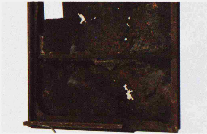
Bild 7. Aufgeschnittenes Fassadenelement mit Perforationen am Aussenblech (PUR-Schaumstoff entfernt)
