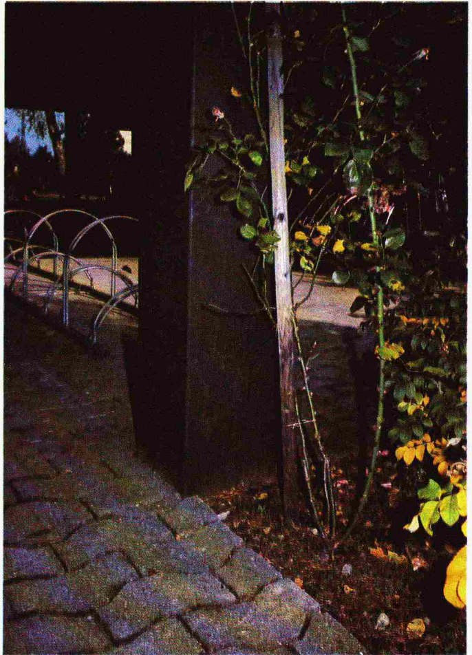
Bild 5. Ungeschützte Stütze in direktem Kontakt mit dem feuchten Erdreich
