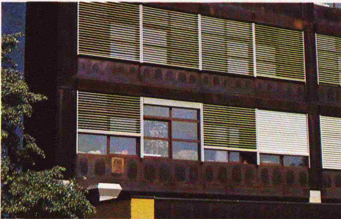
Bild 8. Unregelmässige Färbung von Fassadenelementen, verursacht durch unterschiedliche Wärmeableitung (und damit unterschiedlich lange Feuchtperioden) an Stellen, wo im Elementinnern Stege als Abstandhalter angeheftet waren
