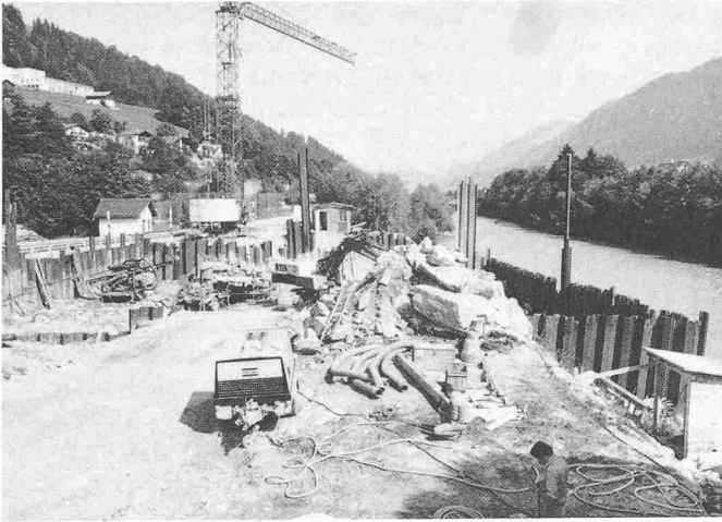
Bild 3. Baustelle Auslauf der Unterwasserkanäle zwischen Kantonsstrasse (links) und Vorderrhein. Baubeginn: 21. Mai 1979. Bauzustand: 11. Sept. 1979
