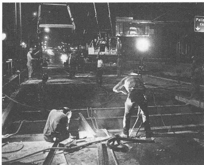
Nach dem Ausbau der Betonfahrbahndecke wird die Unterkonstruktion zur Aufnahme der neuen Fahrbahnplatten vorbereitet
