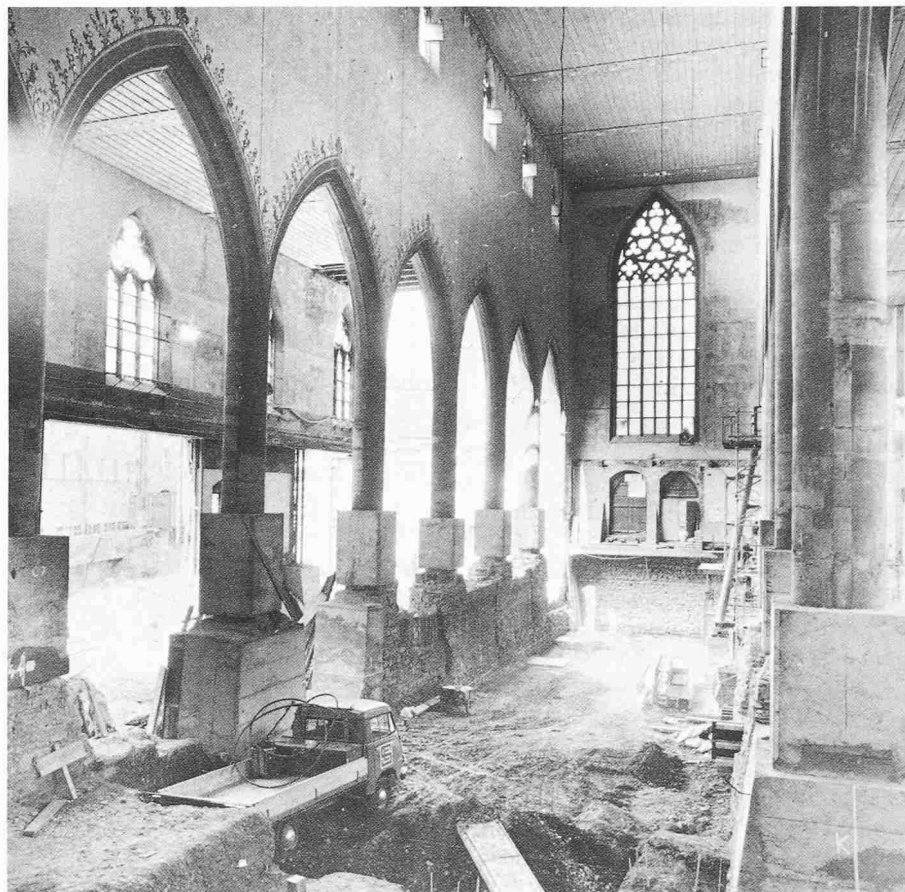
Bild 7. Das Untergeschoss ist ausgehoben. Links sieht man die freigelegte Grundmauer der Nordfassade der ersten Barfüsserkirche. Die Baumeister der zweiten Kirche haben sie als Fundament für die südliche Pfeilerreihe (Achse C) benützt (Aufnahme: 30.4.76)
