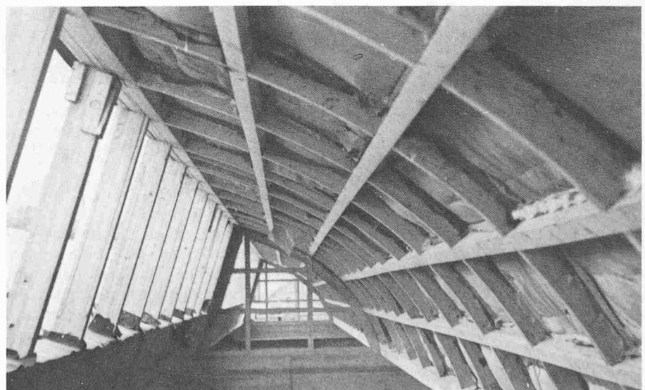
Bild 21. Schalengrost nach E. Staudacher in der Shedkonstruktion einer Industriebaute, 1948. 2 Felder mit je 17 m Stützweite und durchlaufenden Elementen. Jede Shed-Einheit besteht aus einer Rostschale, einem ebenen Rost als Rinnenelement und einem verleimten, ebenen Fensterteil. Ingenieurbüro E. B. Geering, Basel, und Holzbauunternehmungen Osterwald & Bischof, St. Gallen, sowie Gribi & Co. AG, Burgdorf. (Foto EMPA-Holz)
