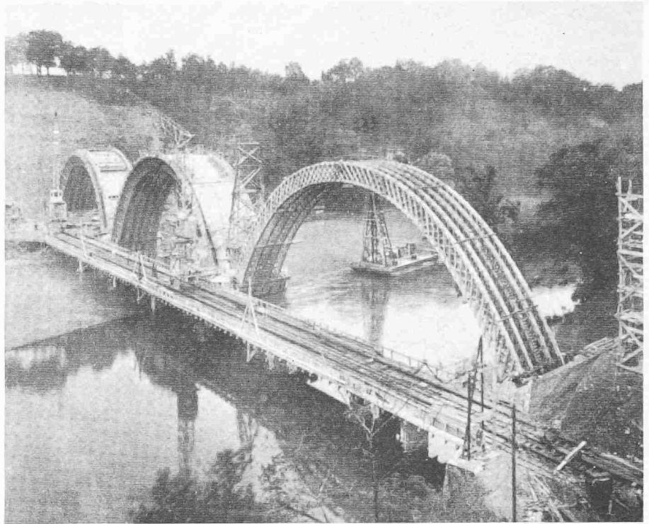
Bild 26. Iehrgerüst des Pont de la Jonction, Genf 1944/45. Stützweiten 57,9-52,3-45,8 m mit verleimten Gurten. Projekt SA Conrad Zschokke und Entreprises réunies Pulver-Olivet zusammen mit Locher & Cie., Zürich [22]
