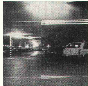
Salviacim-Belag im Parkhaus Bodmergut, Zürich
