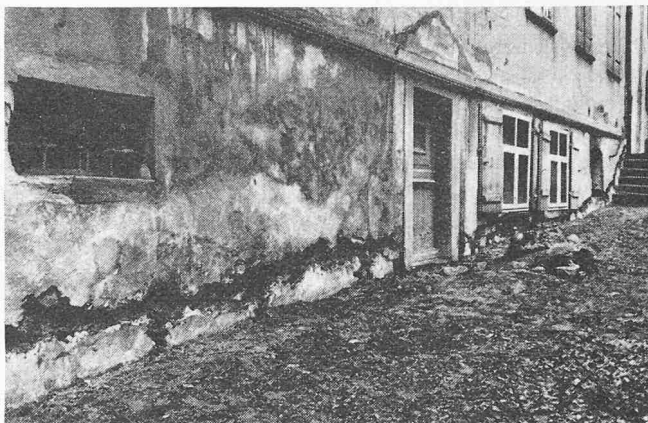
Bild 2. Mauerwerk mit starker Durchnässung. Aufnahme während des Einbaues der Elektroosmose-Entfeuchtungsanlage. Vergleiche auch Bild 8
