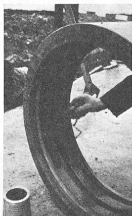
Bild 5. Kupplung eines Asbestzement-Kanalisationsrohres
