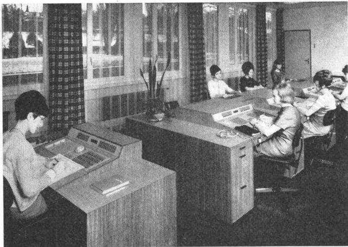
Bild 1. Vermittleraum der Haustelexentrale Hasler SKW 1000 in der Bundesverwaltung (rund 200 Amtslinien, 2500 interne Teilnehmer)
